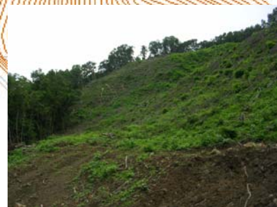
P-4 採石場奥の地山状況 露岩なく風化層厚い。また、斜面が緩急を繰り返しており、地山の弛みが伺える。
