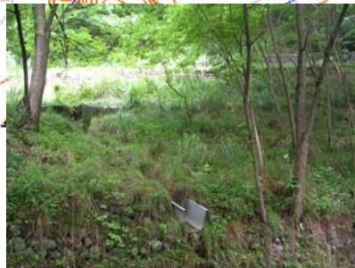
P-1 小規模な地すべり地 蛇かごによる山留工が設置されている。
